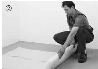
② Es necesario extender una lámina de PE de 0,2 mm de grosor en todos los solados y al efectuarse la instalación sobre calefacción de suelo radiante, debiendo solaparse 30 cm en la zona de unión. A continuación, levantar la membrana por la pared y, tras la instalación de los zócalos, cortarla a rás con el borde superior de éstos.
